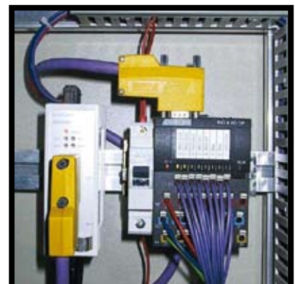
Dezentraler Schaltschrank unter einer SOS-Nische
